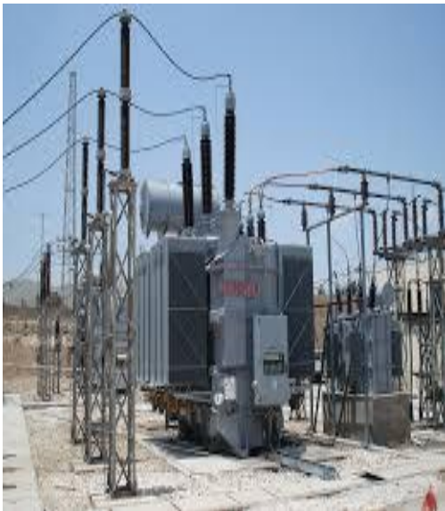
Transformateurs de puissance
